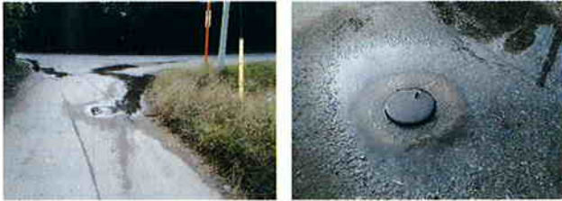
最近あった漏水 横芝光町原方地先(町道) 漏水原因は昭和54年度に布設した鋼管φ50mmのネジ部分の劣化によるものでした。
