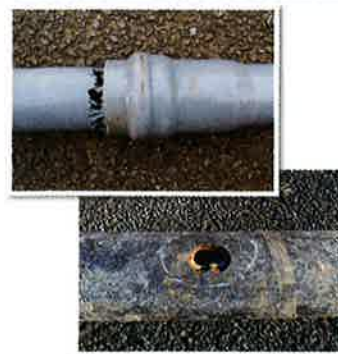
老朽化で漏水した水道管
