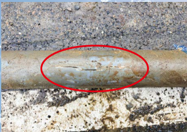
水道管の破損状況 1
