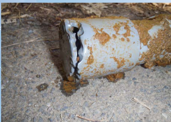
水道管の破損状況 2
