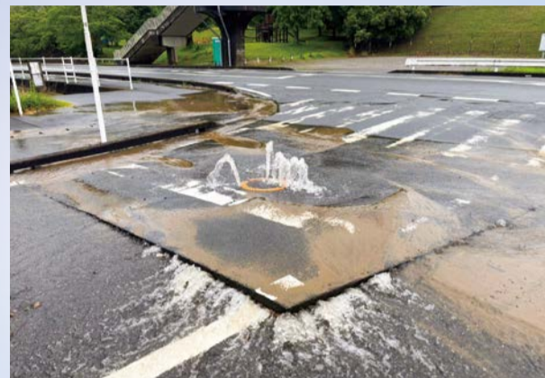
漏水による路面状況
