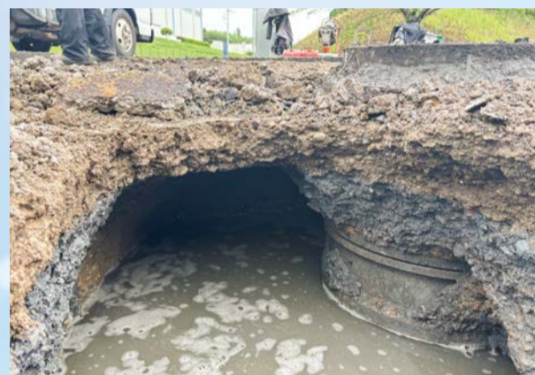
漏水による地中の空洞
