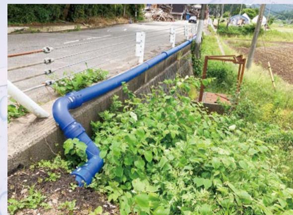
令和6年能登半島地震被災時に使用された耐震管(仮設管)
