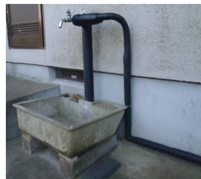
※むき出しの管に保温材使用の例
